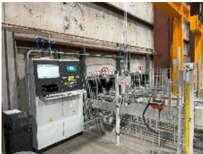
Bild 6: Permanente Bestandsübersicht: UNICOMPACT 5.0 und KASTologic erfassen alle Lager- und Materialbewegungen digital und automatisch.
