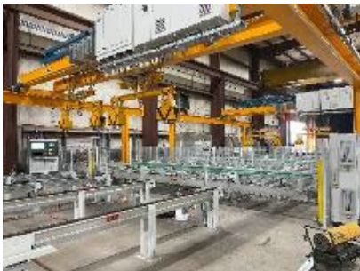
Bild 4: Schnelle Abläufe, zuverlässige Auslieferung – an der vollautomatischen Kommissionierstation.
